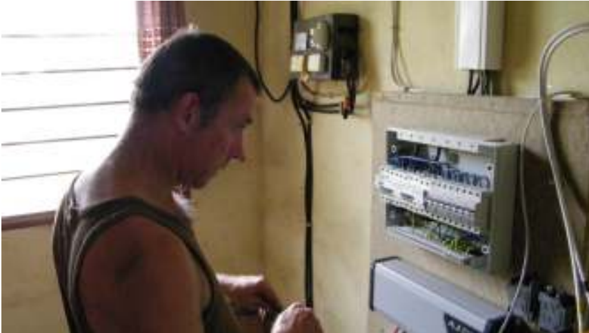
Dirk bekabelt het controlepaneel
